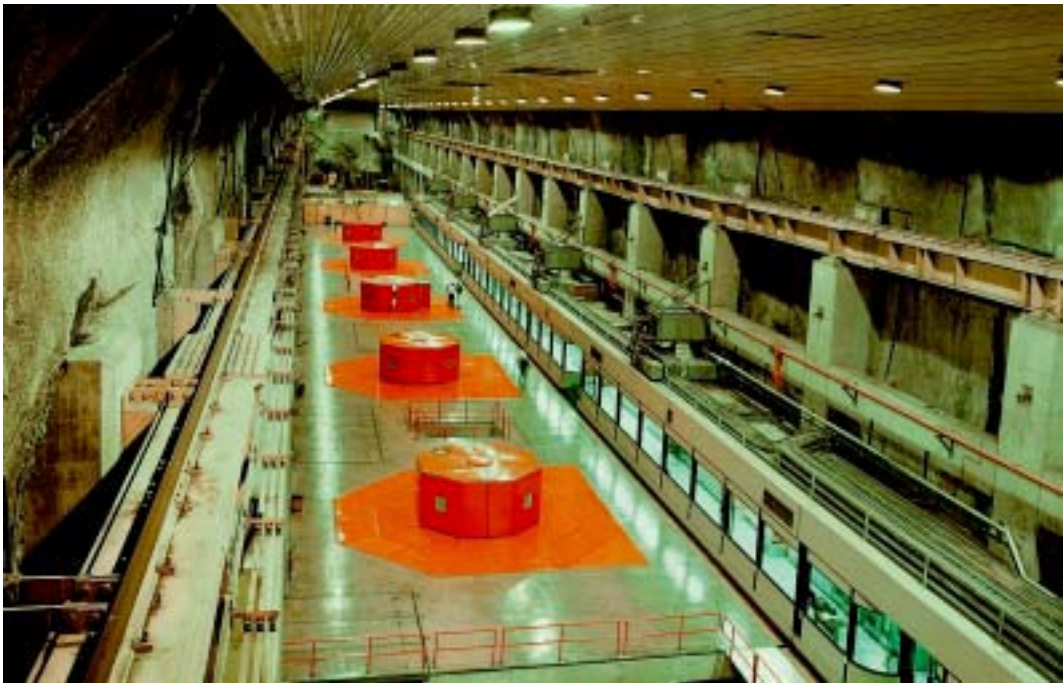
EL GUAVÍO HYDROELECTRIC PLANT, COLOMBIA
